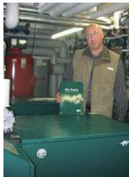
Mit dem Betrieb der zwei Blockheizkraftwerke, so die Aussage von Hartmut Paulmann als technischem Mitarbeiter der Hausverwaltung Isernhagen, arbeitet die Anlage wirtschaftlich und umweltschonend und produziert zugleich energiesparende Wärme und Strom.
